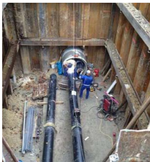
Start- bzw. Zielgrube der Unterquerung der S-Bahn und Wasserleitung SWM mit einem Stahlbetonschutzrohr DN 1200/1500
